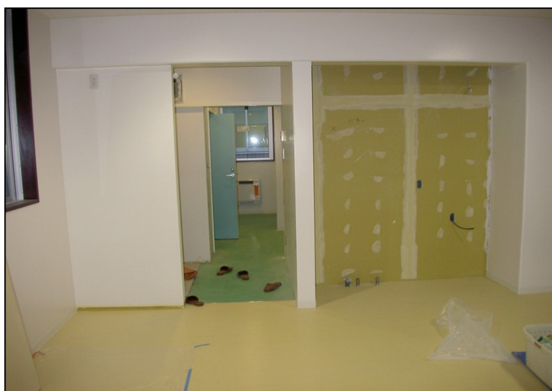
位置: 1F 水廻り室 撮影日: 令和3年12月9日
