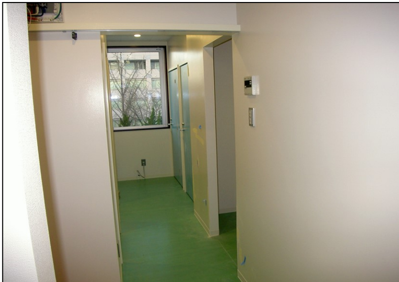
位置: 3F 水廻り室 撮影日: 令和3年12月9日 建具工事: 建具釣込み
