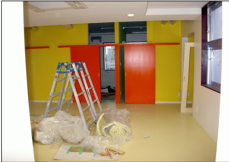
位置: 3F 交流スペース 撮影日: 令和3年12月9日 建具工事: 建具釣込み
