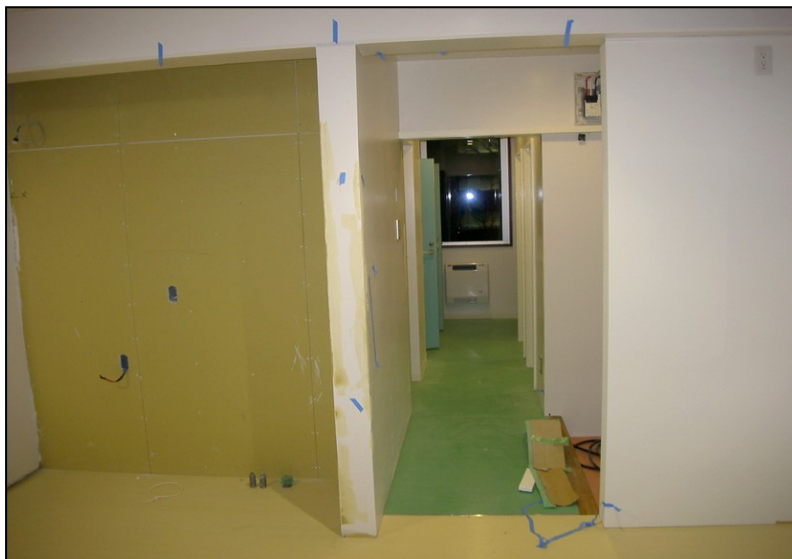
位置: 2F 水廻り室 撮影日: 令和3年12月9日
