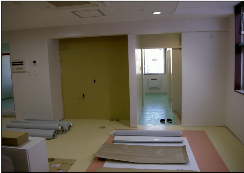
位置: 2F 水廻り室 撮影日: 令和3年12月6日 建具工事: 木製建具吊込み
