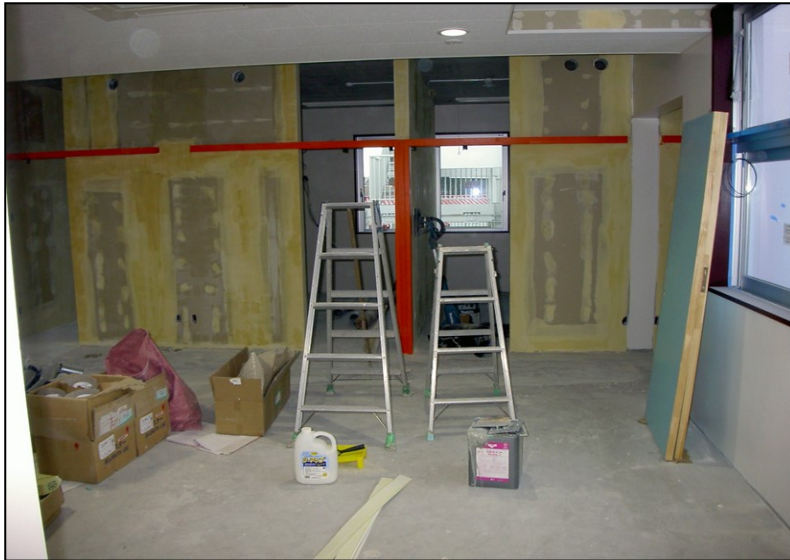
位置: 3F 交流スペース 撮影日: 令和3年11月30日 内装工事:クロス下地処理
