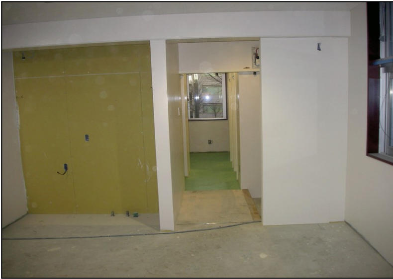
位置: 2F 水廻り室 撮影日: 令和3年11月29日
