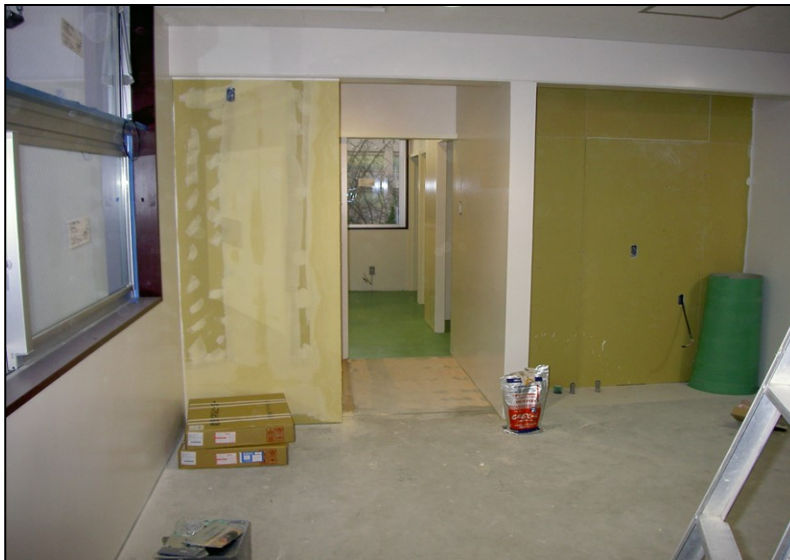
位置: 3F 水廻り室 撮影日: 令和3年11月29日 内装工事: クロス下地処理
