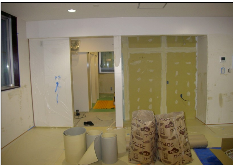
位置: 1F 水廻り室 撮影日: 令和3年11月29日
