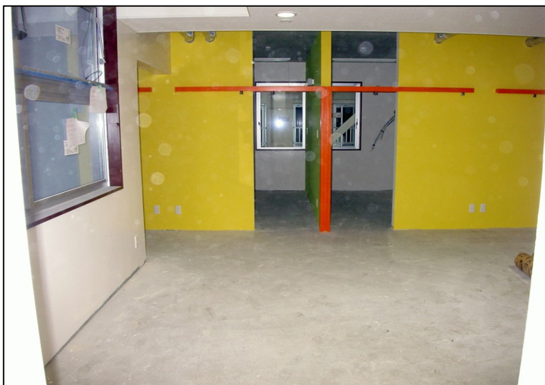
位置: 2F 交流スペース 撮影日: 令和3年11月29日 内装工事: 床長尺塩ビシート張り
