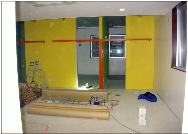
位置: 1F 交流スペース 撮影日: 令和3年11月22日 内装工事: 床長尺塩ビシート張り
