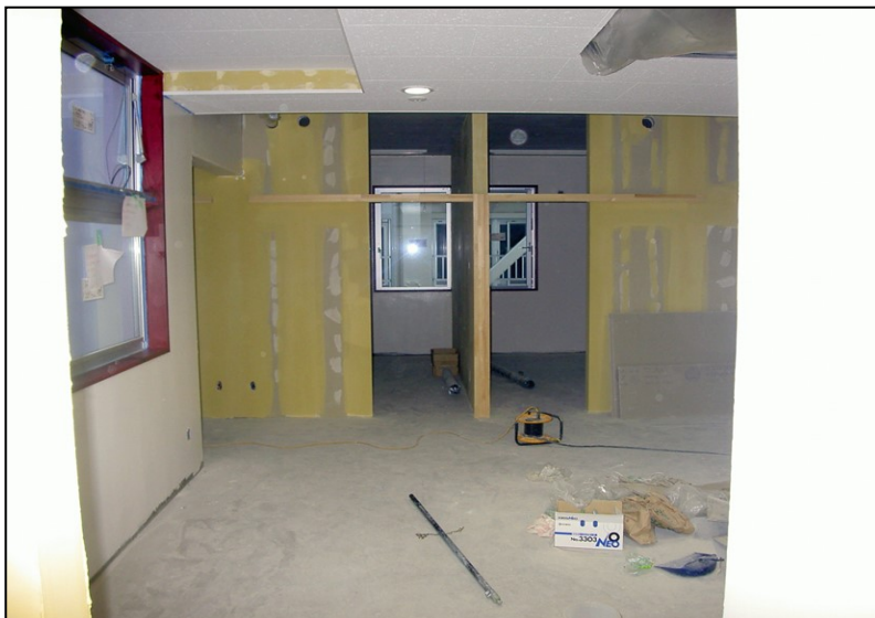
位置: 2F 交流スペース 撮影日: 令和3年11月18日 塗装工事: 塗装
