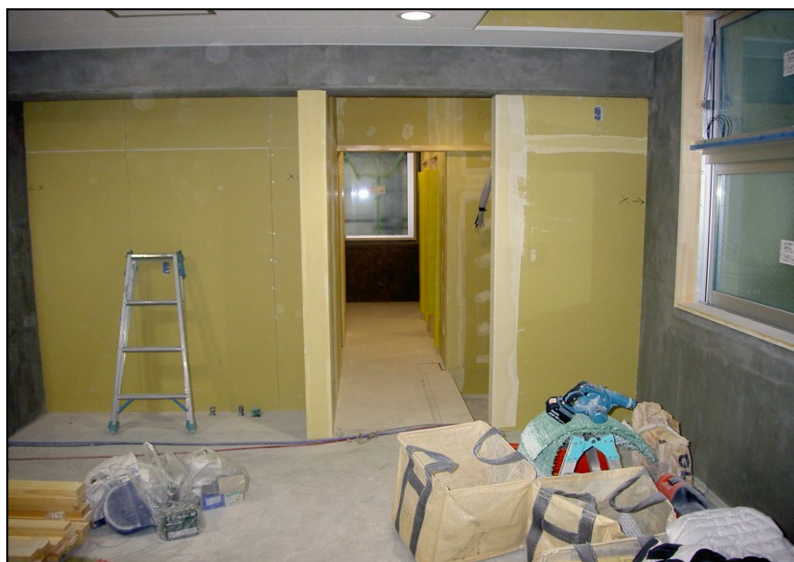
位置: 2F 水廻り室 撮影日: 令和3年11月9日 塗装工事: 壁下地処理
