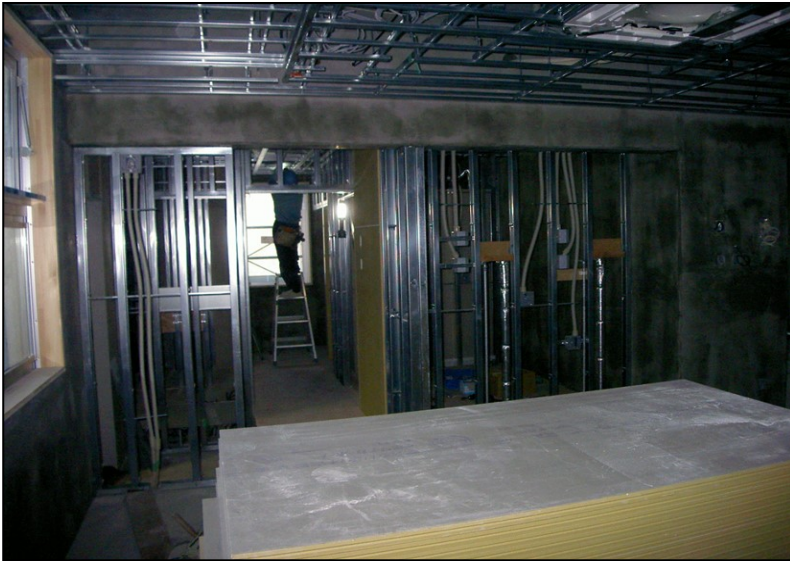
位置: 3F 水廻り室 撮影日: 令和3年11月4日 電気工事:配線工事
