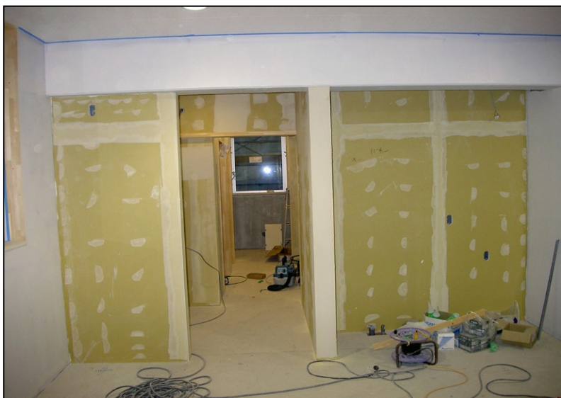
位置: 1F 水廻り室 撮影日: 令和3年11月4日 塗装工事: 壁ボード下地処理
