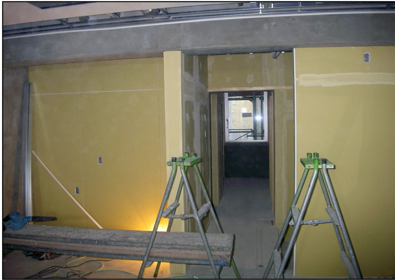
位置: 2F 水廻り室 撮影日: 令和3年11月4日 塗装工事: 壁ボード下地処理
