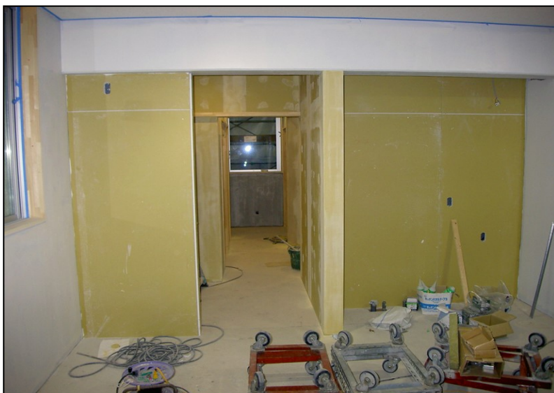
位置: 1F 水廻り室 撮影日: 令和3年11月2日 塗装工事: 壁ボード下地処理
