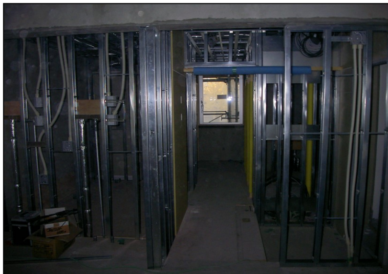
位置: 2F 水廻り室 撮影日: 令和3年10月28日
