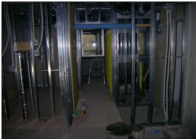
位置: 2F 水廻り室 撮影日: 令和3年10月26日 木工事: 木製建具枠取付
