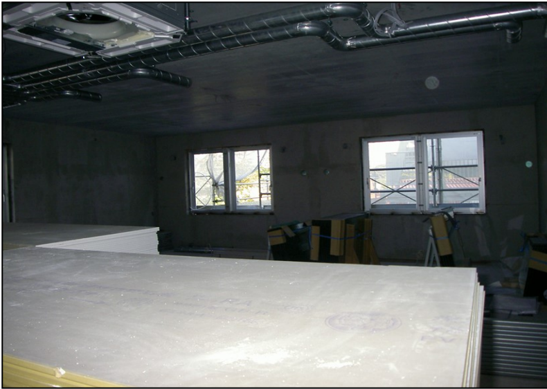
位置: 3F 交流スペース 撮影日: 令和3年10月19日 設備工事:ダクト工事
