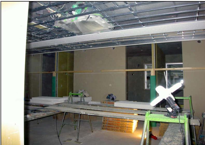
位置: 1F 交流スペース 撮影日: 令和3年10月18日 内装工事: 天井ボード張り
