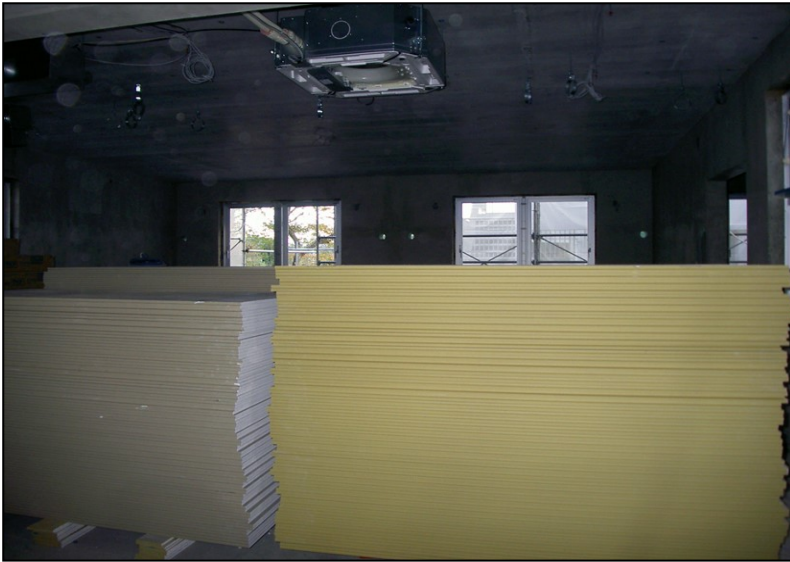
位置: 3F 交流スペース 撮影日: 令和3年10月18日 ガラス工事: ガラス搬入
