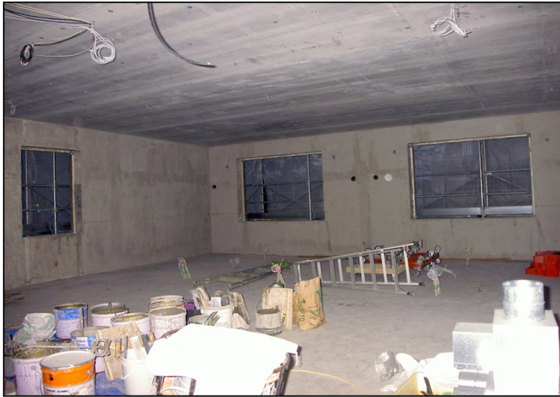
位置: 3F 交流スペース 撮影日: 令和3年10月13日 電気工事: 配線工事
